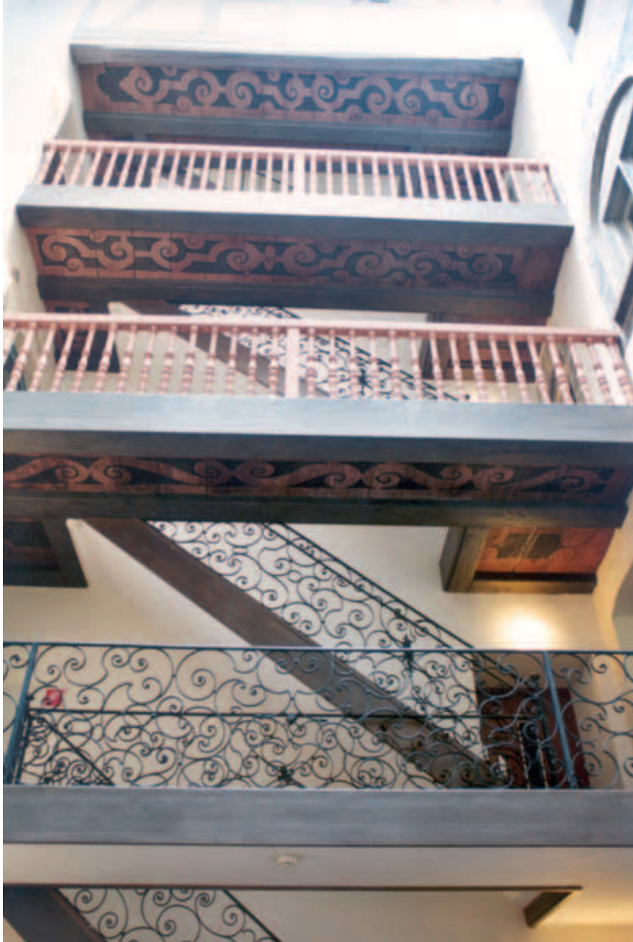
Untersichten der Treppenbalkone im Lichthof des Hauses zum Untern Rech (Foto: Giorgio Hoch)
